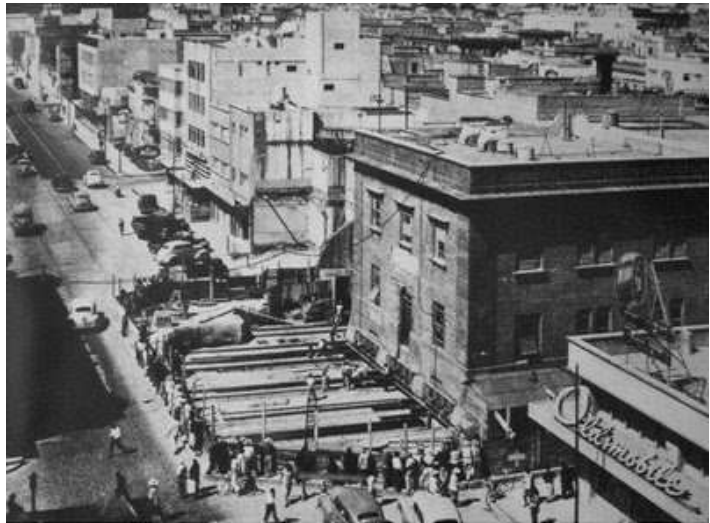
Imagen 16 - Desplazamiento del edificio de Telefónica para dar paso a la Av. Juárez en 1950
