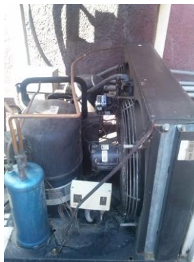
Condensador de cuarto frío
