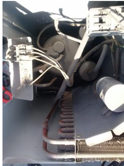
Condensador de aire acondicionado
