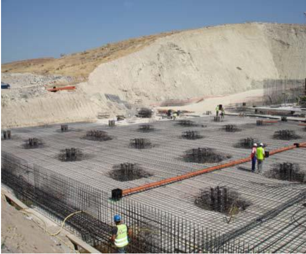
Ilustración 27 Proceso de armado de losa de cimentación y elementos de conexión pilotes, losa y pilares. Fuente: http://server.geo5.cn
