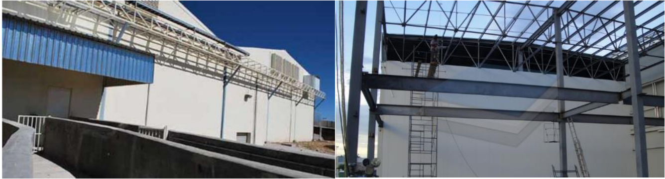
Ilustración 29 Fotos de naves climatizadas con paneles aislantes. Archivo MACC
