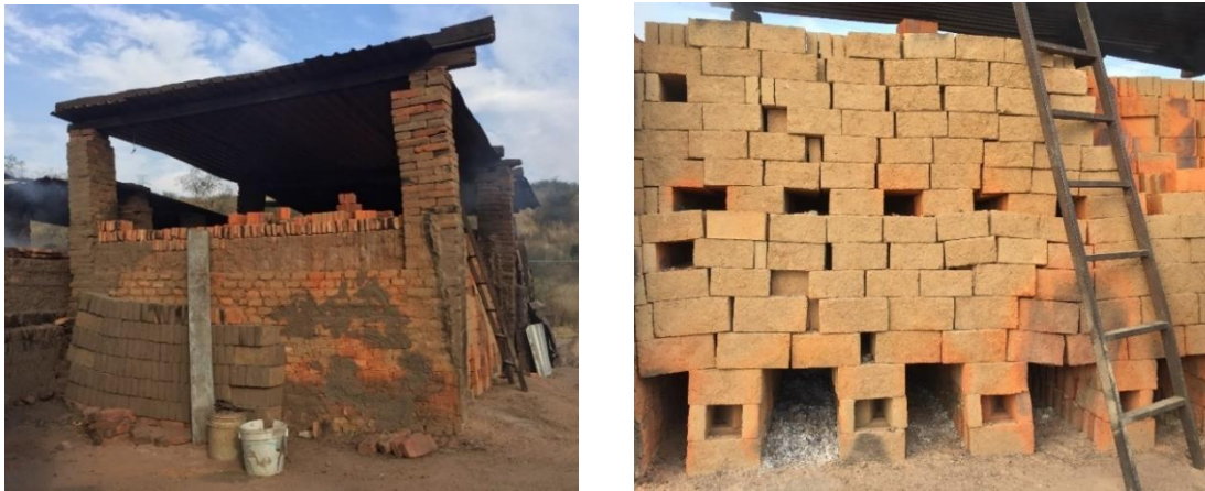
Fig. 33 Área de horneado. Horno tipo “campaña” en la ladrillera ubicada en Tlajomulco de Zúñiga. Fuente (Imagen propia PAP)
