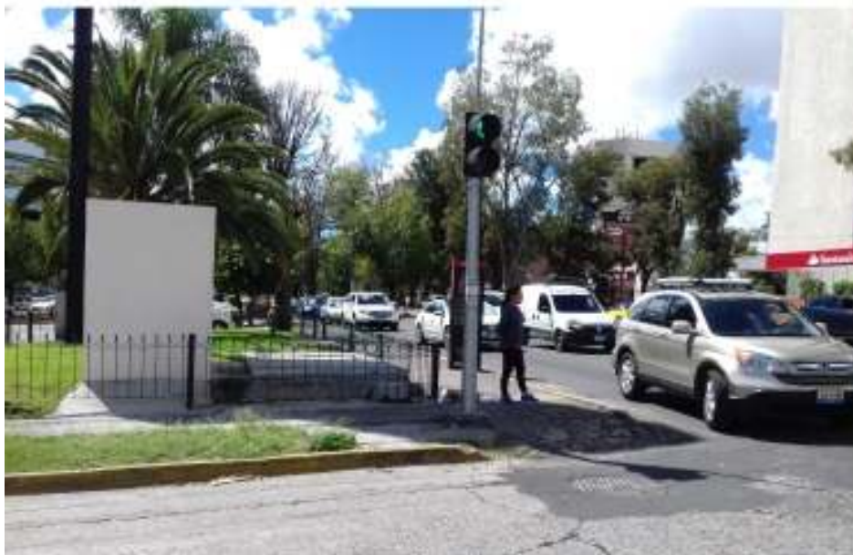
Ilustración 32. Banqueta en mal estado, falta de rampas adecuadas para subir a la banqueta, carencia de señalización en piso y nombres de las calles en las esquinas.
