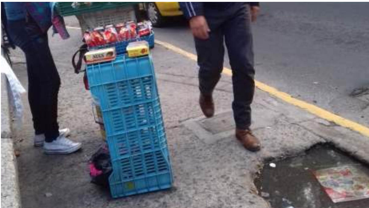
Ilustración 37 Estado actual de las banquetas. Presencia de baches y disminución de área transitable por la presencia de puestos comerciales.
