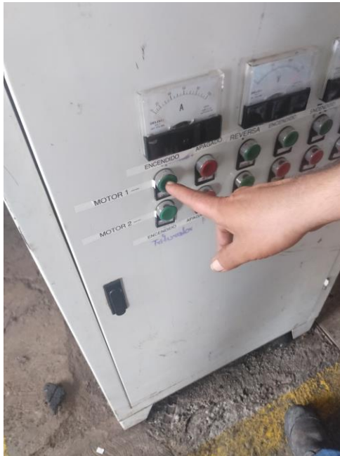
Figura 49. Etiquetas en el tablero de control
