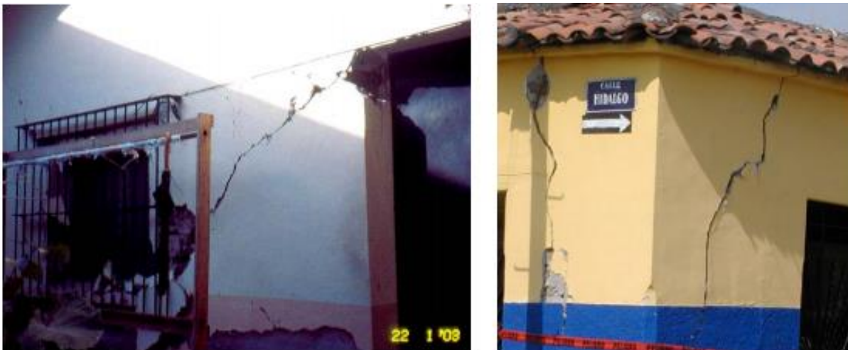
Ilustración 1 Agrietamiento en diagonal sismo 2003, vivienda de adobe. Fuente: CENAPRED.
