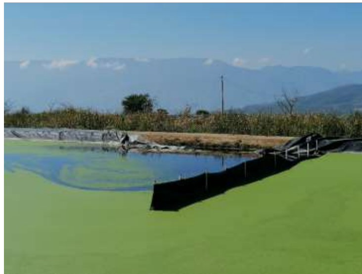
Figura 22. Laguna de maduración “B” con daños de la membrana en sus bordos (Fuente: Archivo fotográfico de visitas al sitio).
