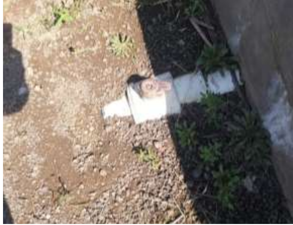
Figura 19. Válvula de extracción de lodos dañada (Fuente: Archivo fotográfico de visitas al sitio).
