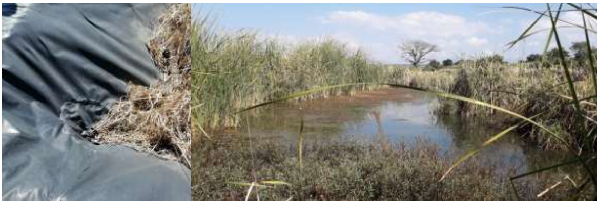
Figura 20. Humedal de sobrenadante “A” con línea de distribución faltante y flujo superficial (Fuente: Archivo fotográfico de visitas al sitio).
