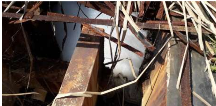
Figura 15. Vertedero roto en la caja de paso (Fuente: Archivo fotográfico de visitas al sitio)
