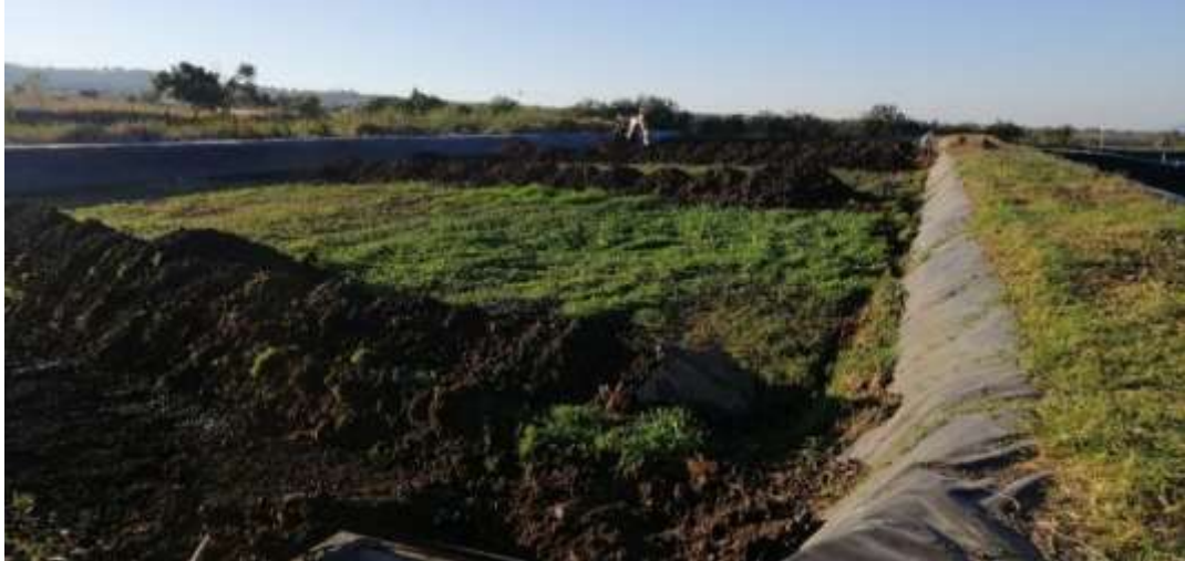
Figura 25. Excavación de las zanjas de infiltración (Fuente: Archivo fotográfico del proyecto de rehabilitación).
