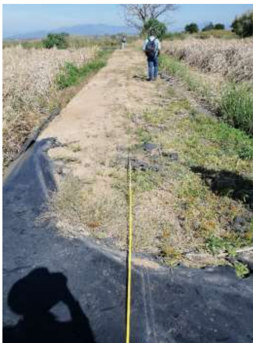
Figura 17. Revisión de daños a la membrana entre humedales (Fuente: Archivo fotográfico de visitas al sitio).
