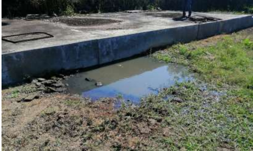
Figura 14. Caja de bifurcación inundada (Fuente: Archivo fotográfico de visitas al sitio).
