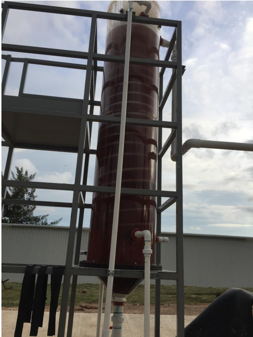
Figura 27 Tanque del FBRH
