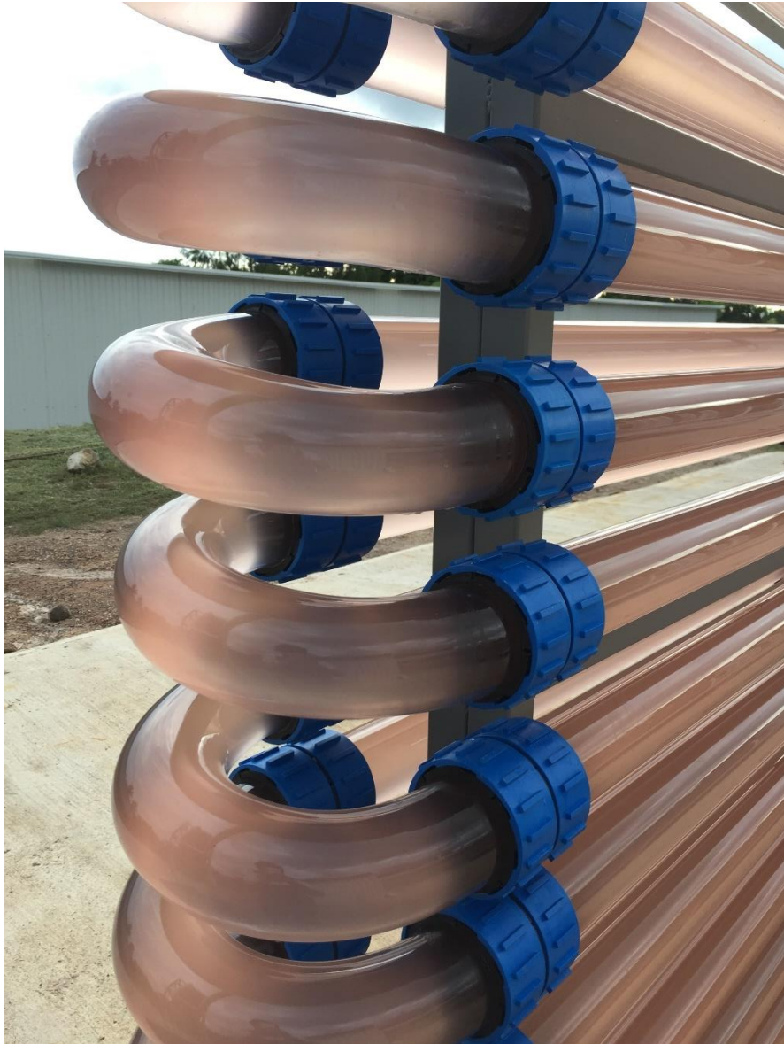
Figura 25 Acercamiento a codos del FBRH
