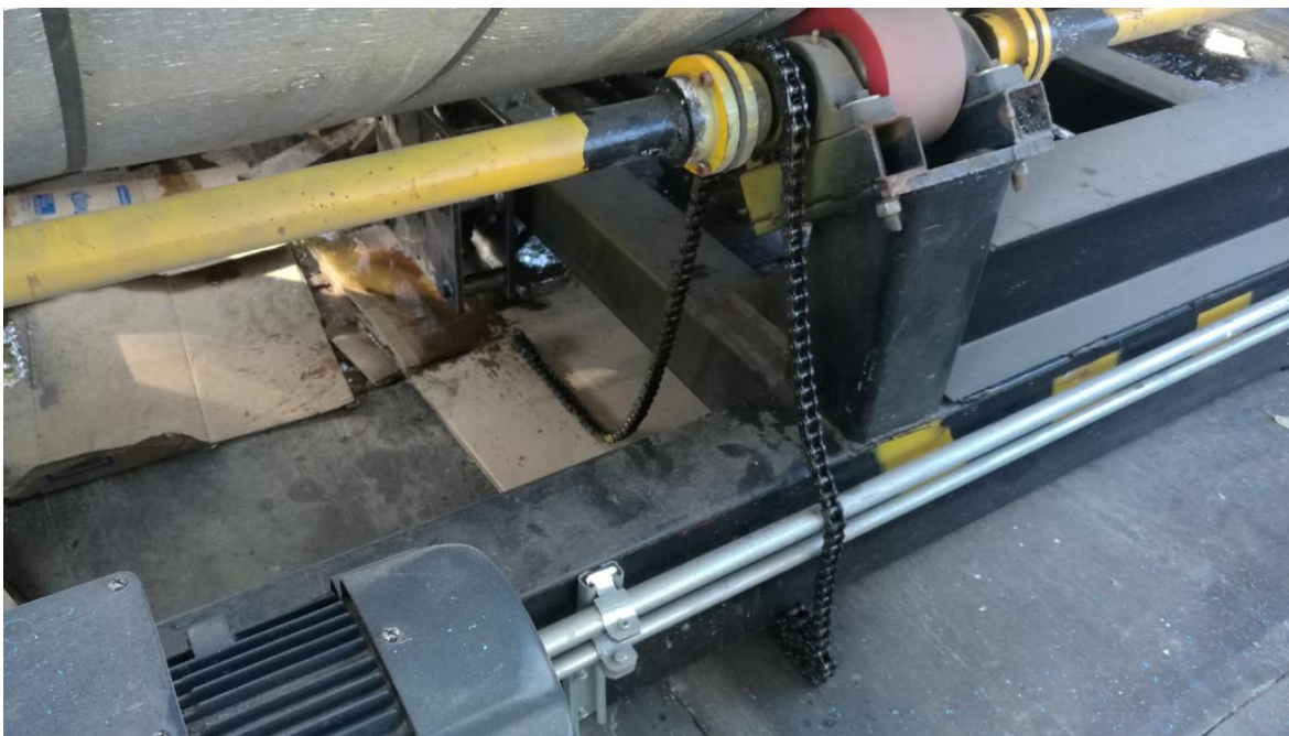
Figura 14. Falla en cadenas de transmisión
