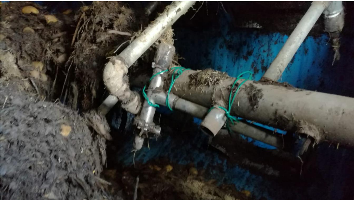
Figura 13. Desprendimiento de tubos de sensores por la fuerza ejercida por la mezcla
