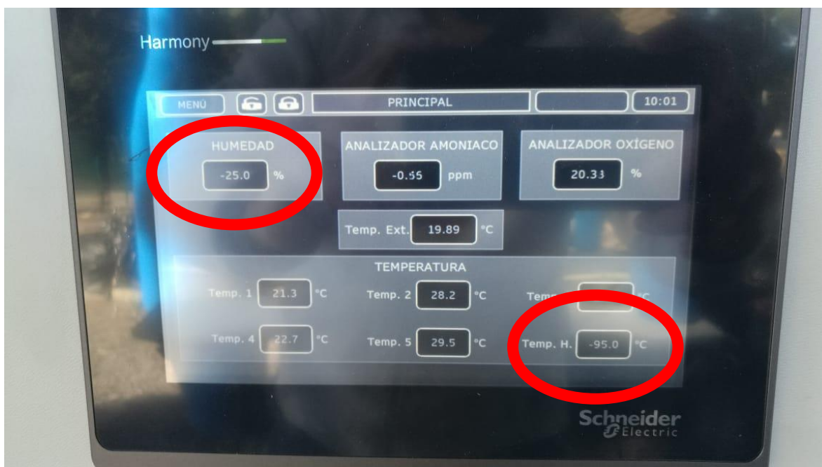
Figura 15. Falla en sensores de humedad y temperatura
