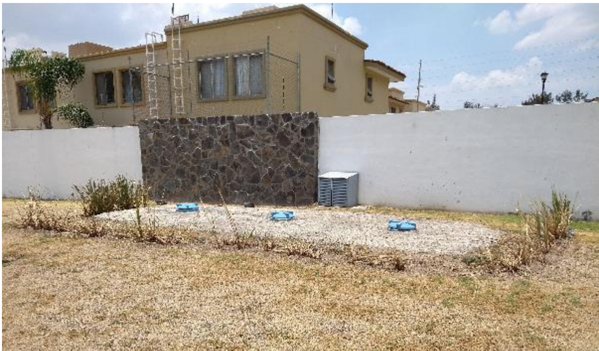
Figura 5-6 Cisternas de agua potable ubicadas en el jardín de la entrada principal.
