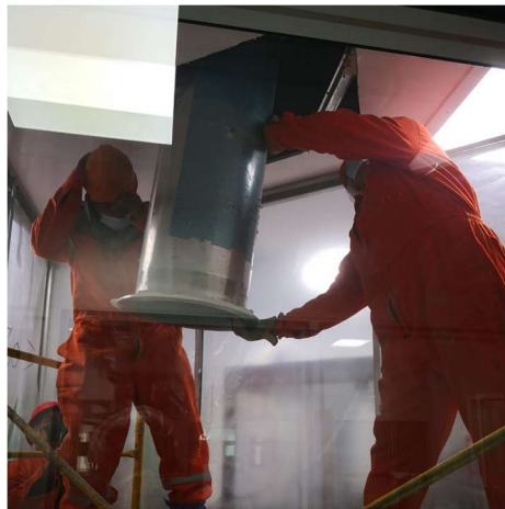
Figura 1. Ducto de descarga de polvos
