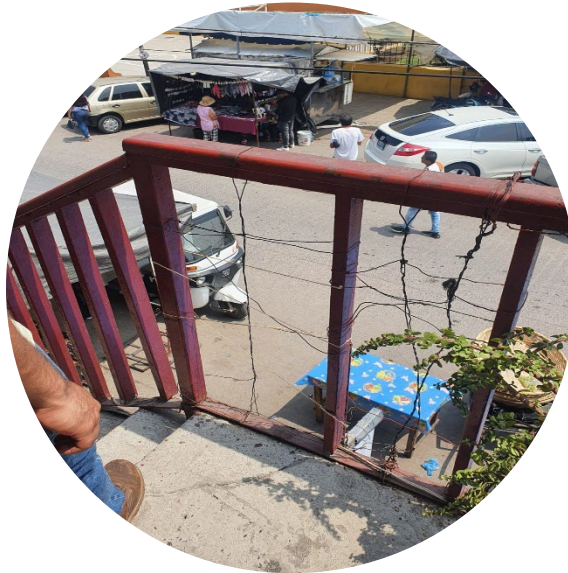
Barandal de terraza roto. Elaboración propia
