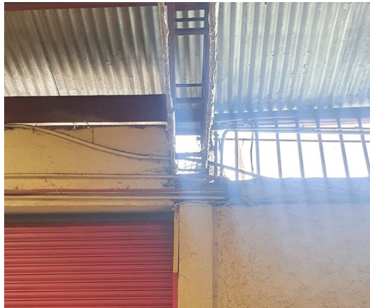
Excentricidad en conexión de armadura con columna. Elaboración propia
