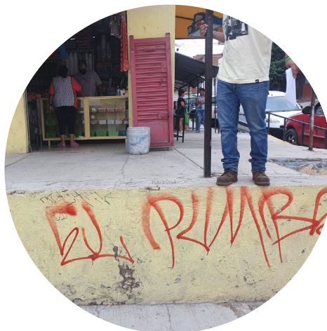
Banqueta con elevación de alrededor de 1.5m sin barandal de seguridad. Elaboración propia
