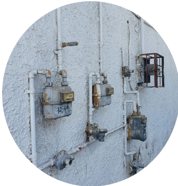
Tubería de gas con olor de Mercado San Pedrito. Elaboración propia
