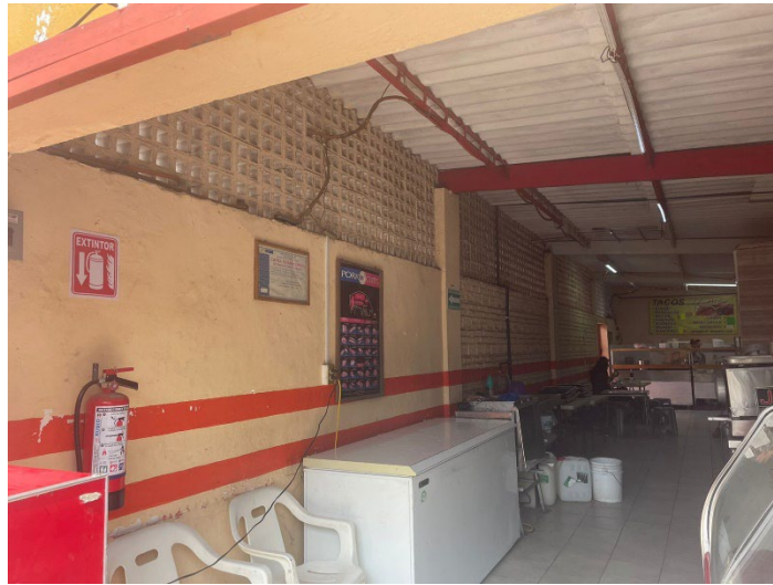
Lamina de asbesto en interior de mercado Tateposco. Elaboración propia
