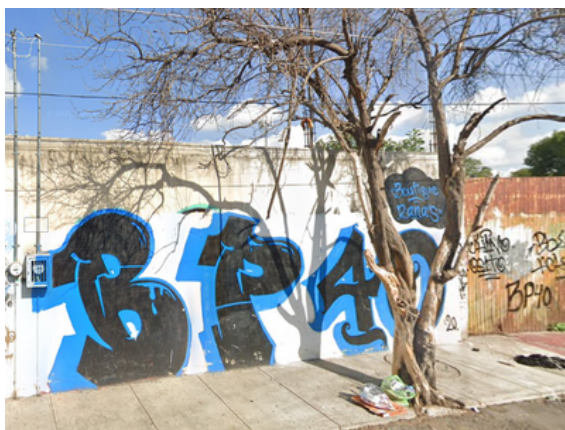
Muros de fachadas grafiteadas
