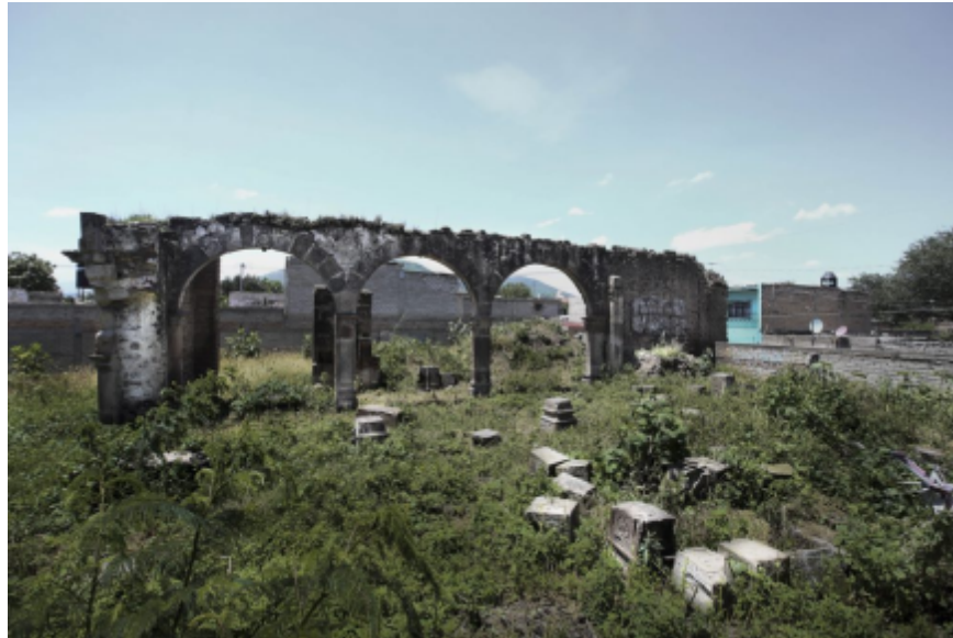
Imagen 21. El descuido y abandono de las ruinas de la capilla de San Sebastián El Grande
