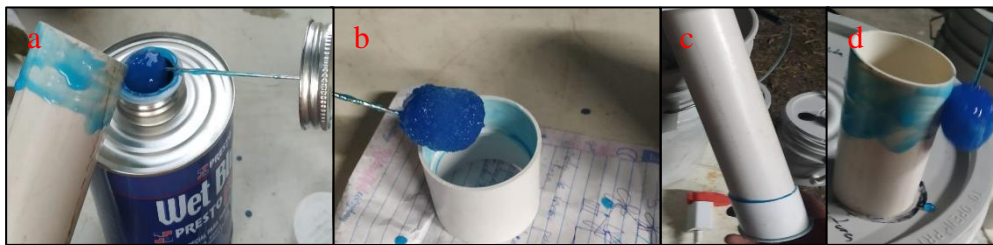
Figura 16. Aplicación del pegamento PVC en tubos 2" (a), coples (b), su unión por debajo de la tapa (c) y pegado por arriba (d).
