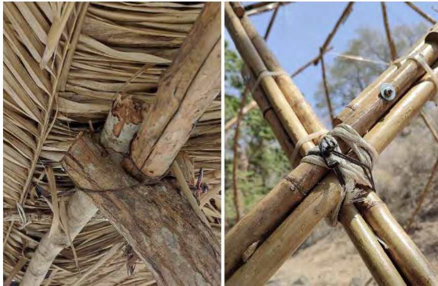
Figura 56-6. Unión de “palapa” hecha en la comunidad local y unión propuesta para el sistema.
