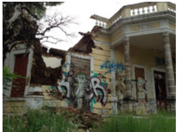
Imagen 5. Fachada de la casa Castiello, después del colapso de 2013. ©El Informador 25/07/2013.
