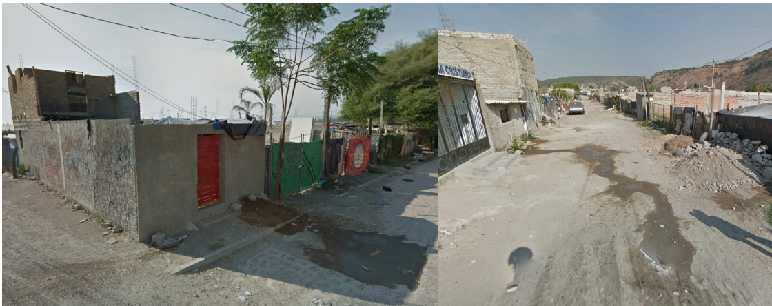
Calles con deterioro en colonia Miramar (Padilla, 2017)
