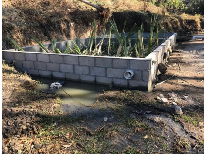
Figura 16. Aldo León, 2018, Comunidad de Cuauhtémoc, Ixtapa, Chiapas. Ultimo estanque de plantas acuáticas con filtración de agua residual.
