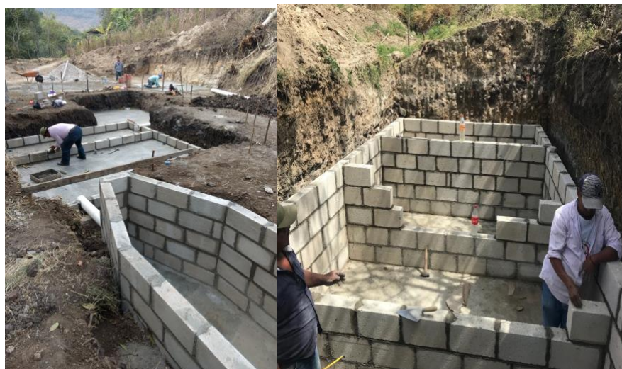
Figura 18. Aldo León, 2018, Comunidad de Cuauhtémoc, Ixtapa, Chiapas. Sistemas de tratamiento de aguas residuales
