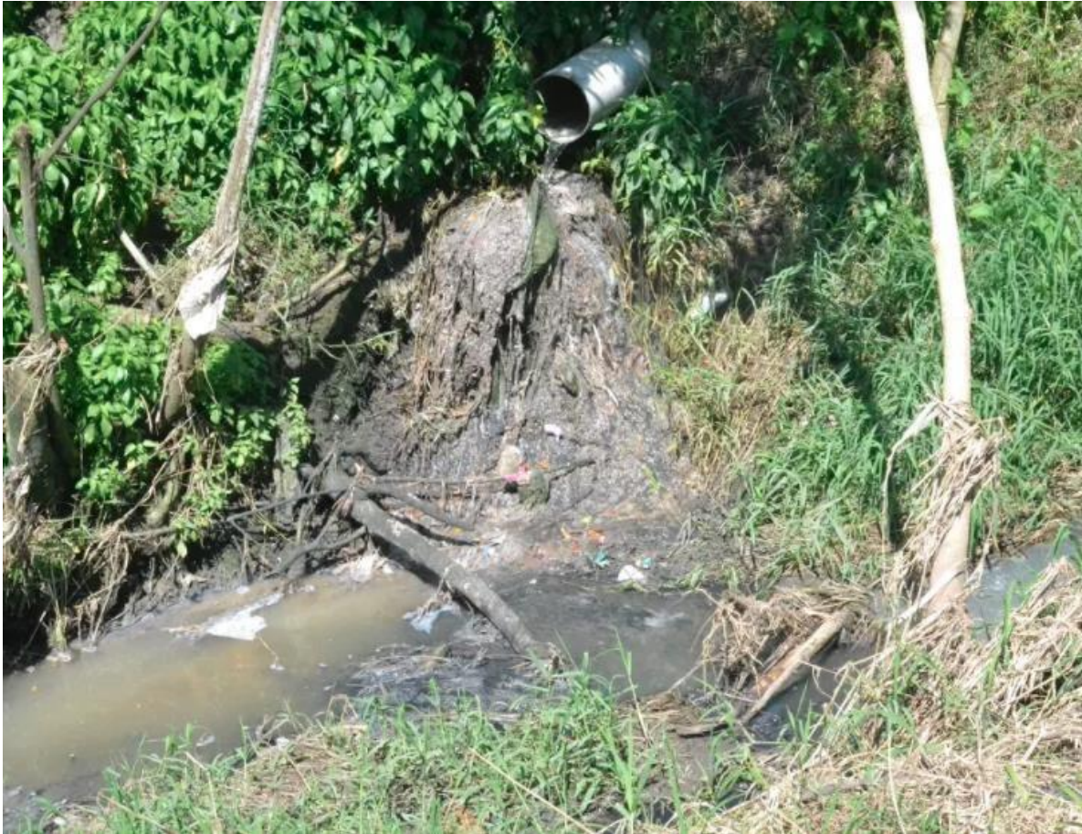
Figura 4. Aldo León, 2017. Descarga de agua residual colonia Aztlán.
