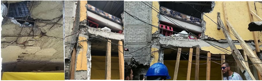
Figura 16. Daños en vivienda autoconstruida, CDMX.
