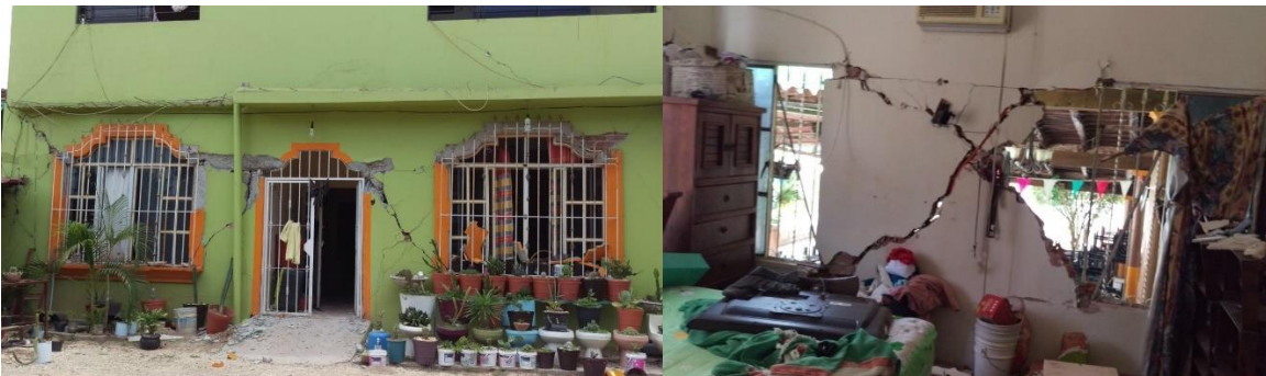
Figura 17. Daños en vivienda autoconstruida, Oaxaca.
