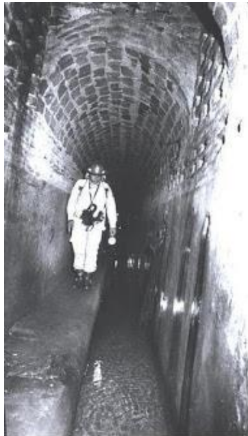
Figura V. 6. Galerías filtrantes en Guadalajara. Ayuntamiento de Guadalajara 2008.
