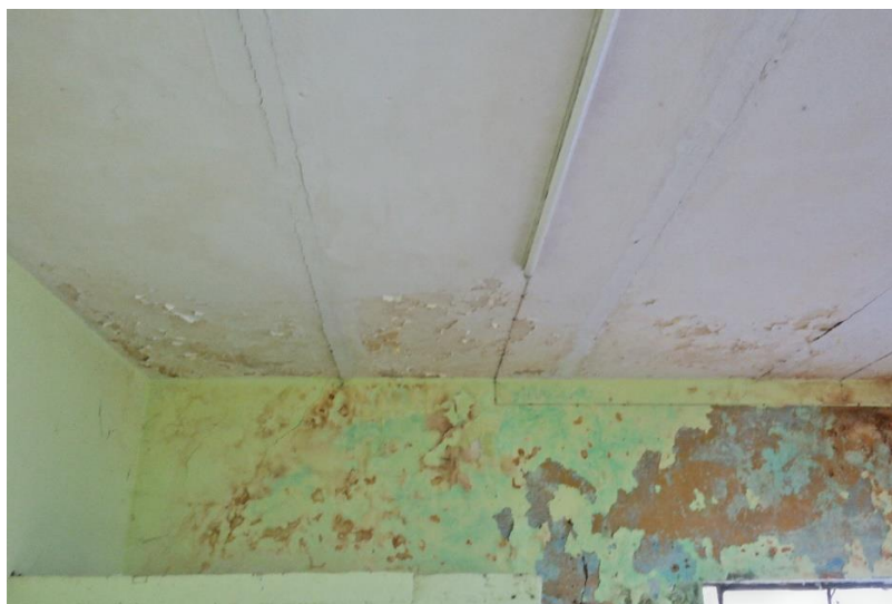
Deflexiones 2 y humedad interior 1
