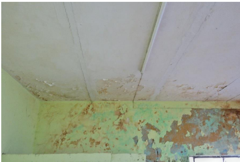
Imagen 1: Identificación de deflexiones y humedades interiores (Mora, 2020).
