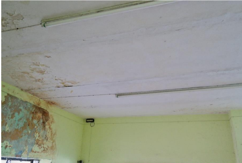
Deflexiones 3 y humedad interior 2
