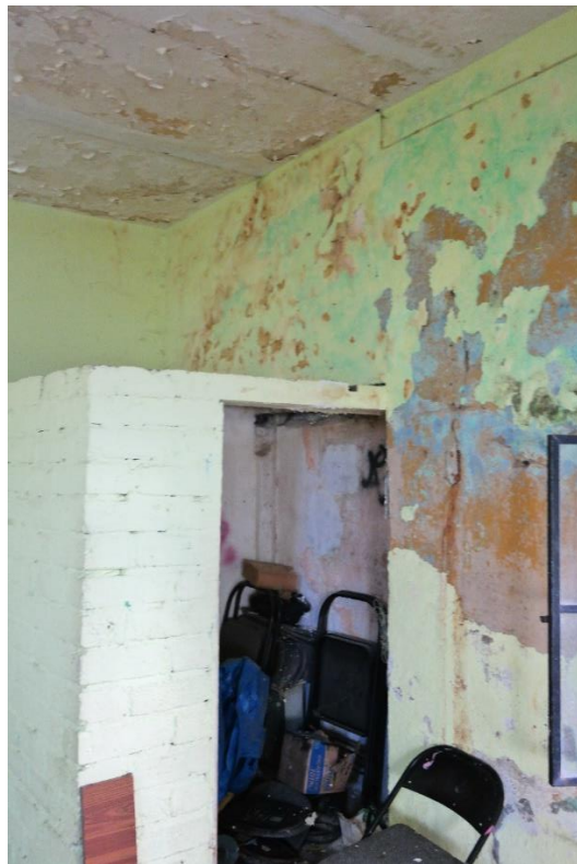
Humedad por condensación interior
