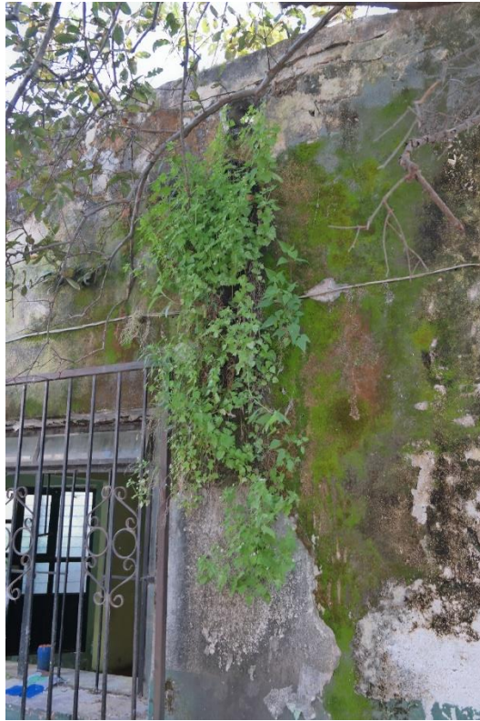
Humedad por condensación exterior
