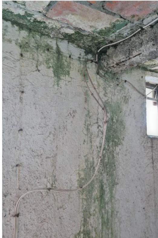
Humedad por filtración
