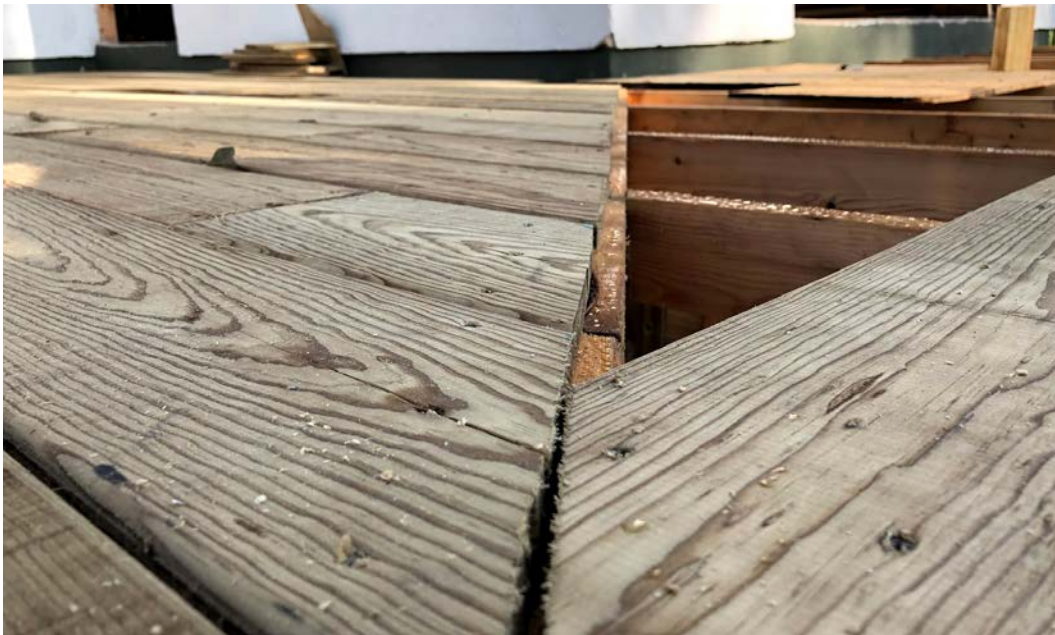
Fig. 2 (Detalle Madera Tratada con CCA)
