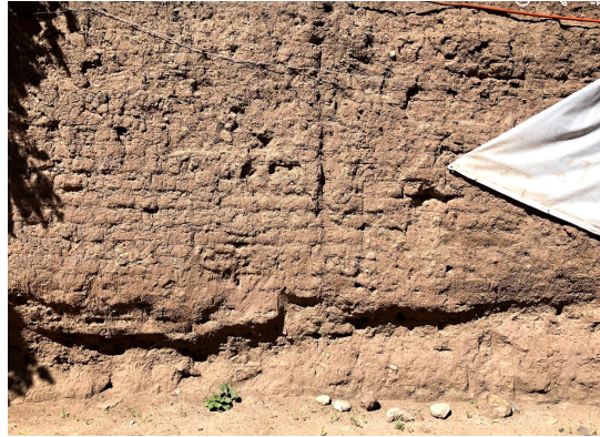
Fig.8 Muro de Estacionamiento erosionado
