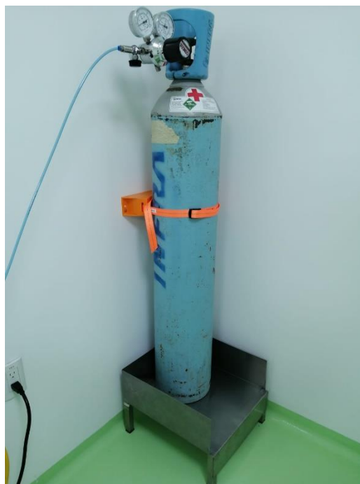
Imagen 2. Tanque de CO2
