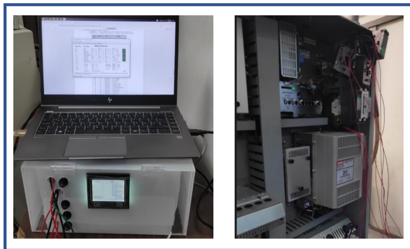
Figura 55 – A la izquierda, Equipo de cómputo conectado al analizador en su caja de almacenamiento y transportación fabricada especialmente para este propósito, a la derecha conexiones eléctricas con los transformadores de corriente en la parte posterior de máquina CNC. (Elaboración propia)
