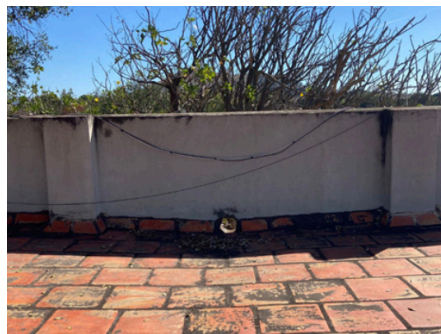
Estado actual de los bajantes de agua pluvial. Imagen 7
