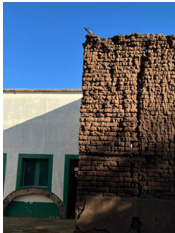
Imagen 5, 6 y 7: Detalle patológico de grieta estructural detectadas
