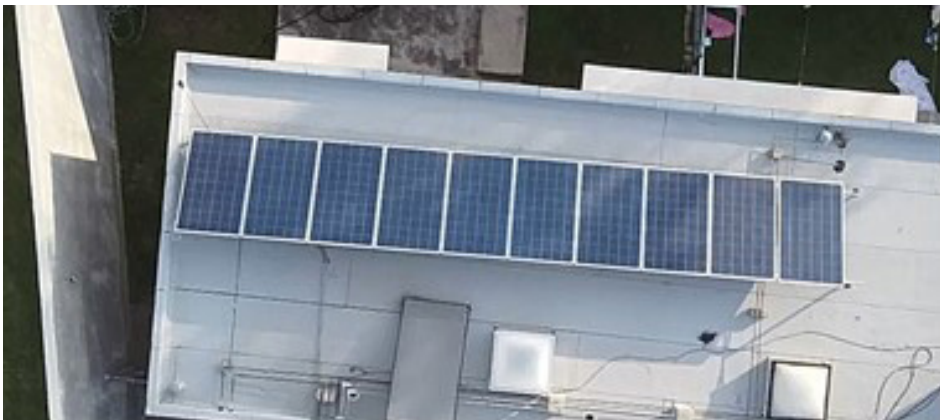
Figura 20.1. Paneles fotovoltaicos instalados en una casa habitación.
