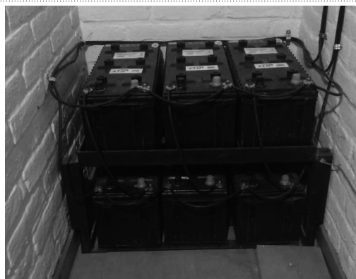
FIGURA 7.6 BANCO DE BATERÍAS PARA SFV TIPO ISLA
