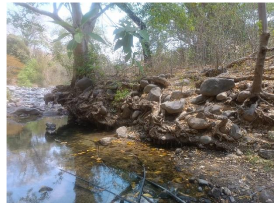
Figura 30. Raíces expuestas de un gran árbol, producto de erosión de las márgenes. (Autoría propia).
