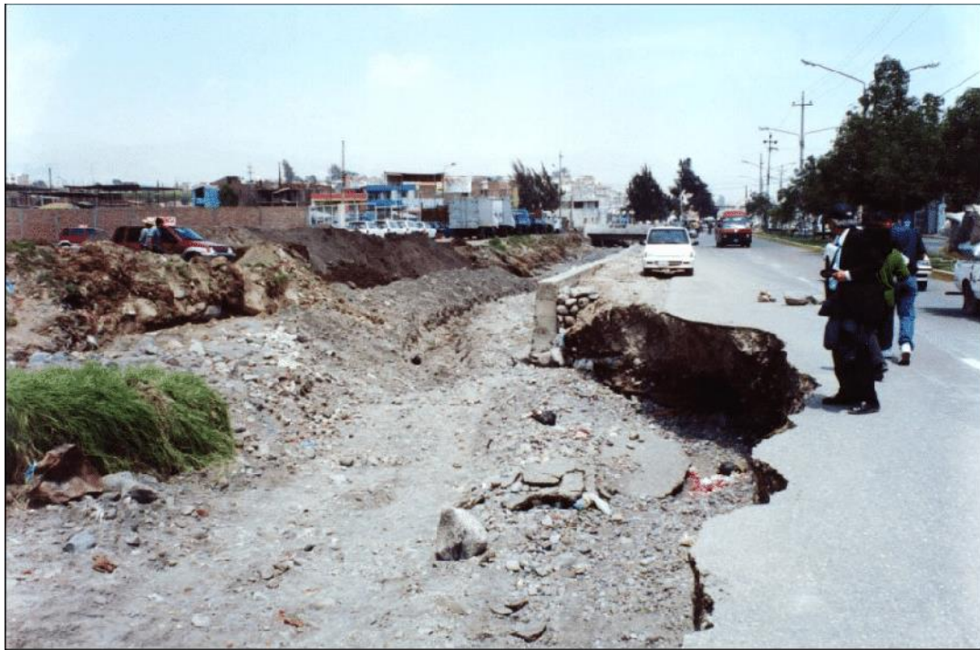
Figura 49. Erosión de pista urbana Arequipa (Kuroiwa, 2002).
