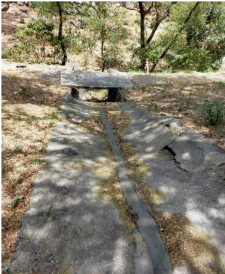
Figura 7. Agua corriendo de una alcantarilla abierta al arroyo. Elaboración propia.
