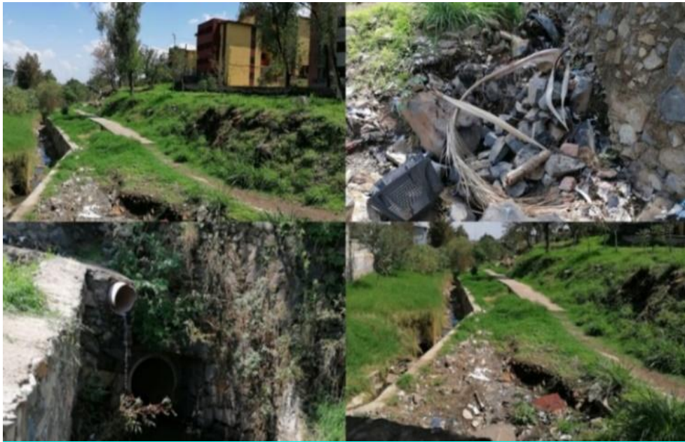
Figura 2. Estado del Arroyo El Azul al cruce con Avenida Río Nilo. Elaboración propia.
