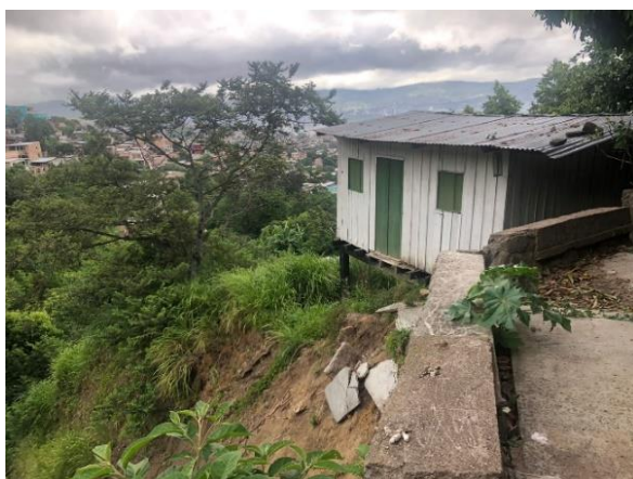
Ilustración 4-4 Vivienda de madera con afectación por deslizamiento de tierra, fuente: Propia-observado en transecto, 2022.
