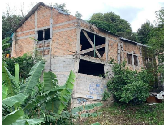
Ilustración 4-3. Afectación por deslizamiento de tierra observado en transecto en la col. José Ángel Ulloa, Fuente: Propia-observado en transecto, 2022
