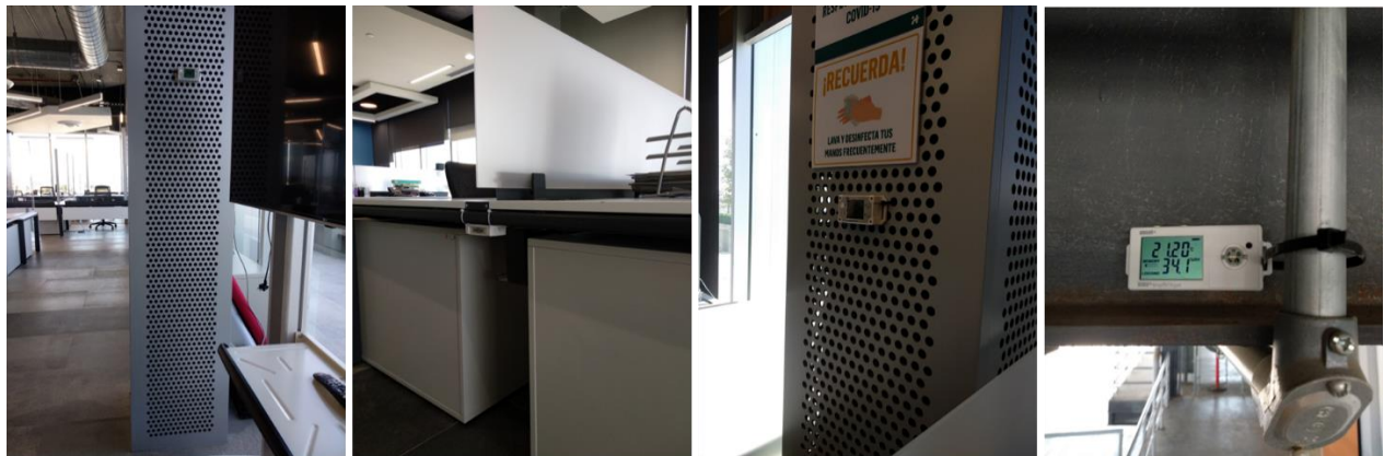
Figura 50. Fotografías de ubicación de equipos.
