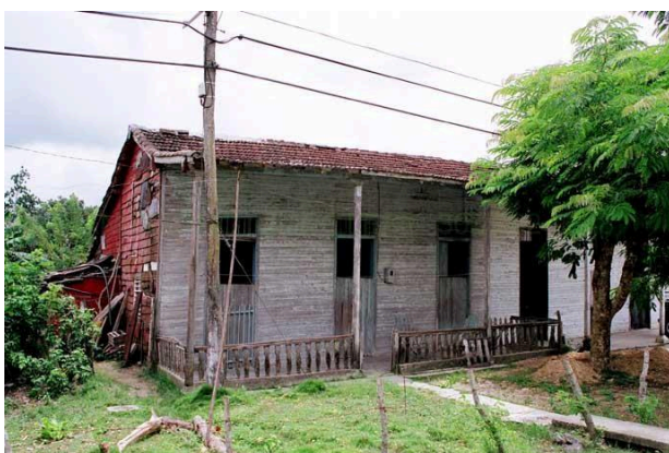
Imagen 16. Fotografía casual que evidencia el deterioro del poblado. Elaboración propia.
