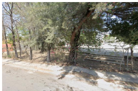
Figura 37. Banquetas en mal estado en calle Emilio Carranza.
