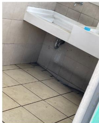
Fuga de agua gris
