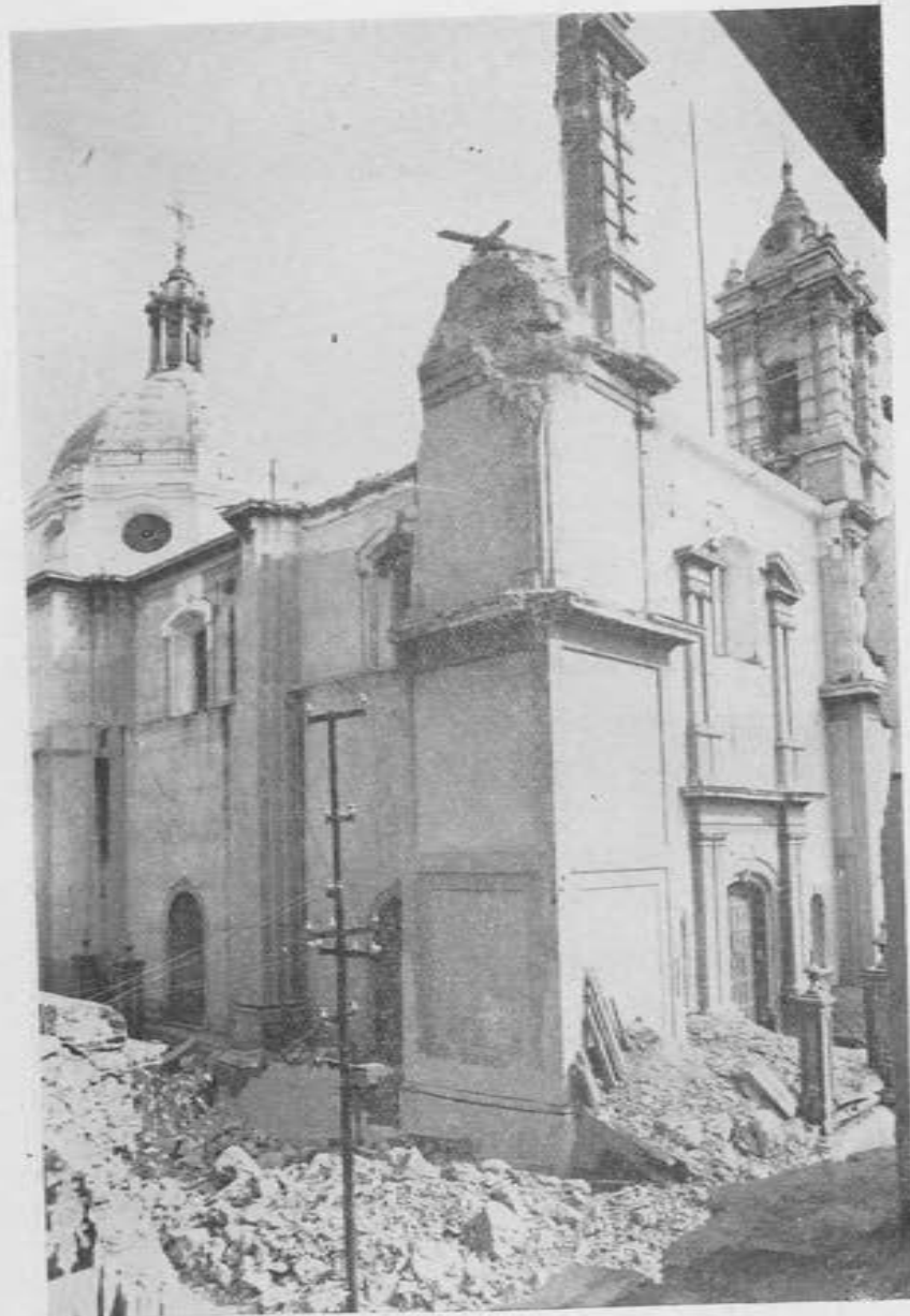
Estado exterior en que quedó la Catedral de Colina a causa de los fuertes temblores del mes de abril.
