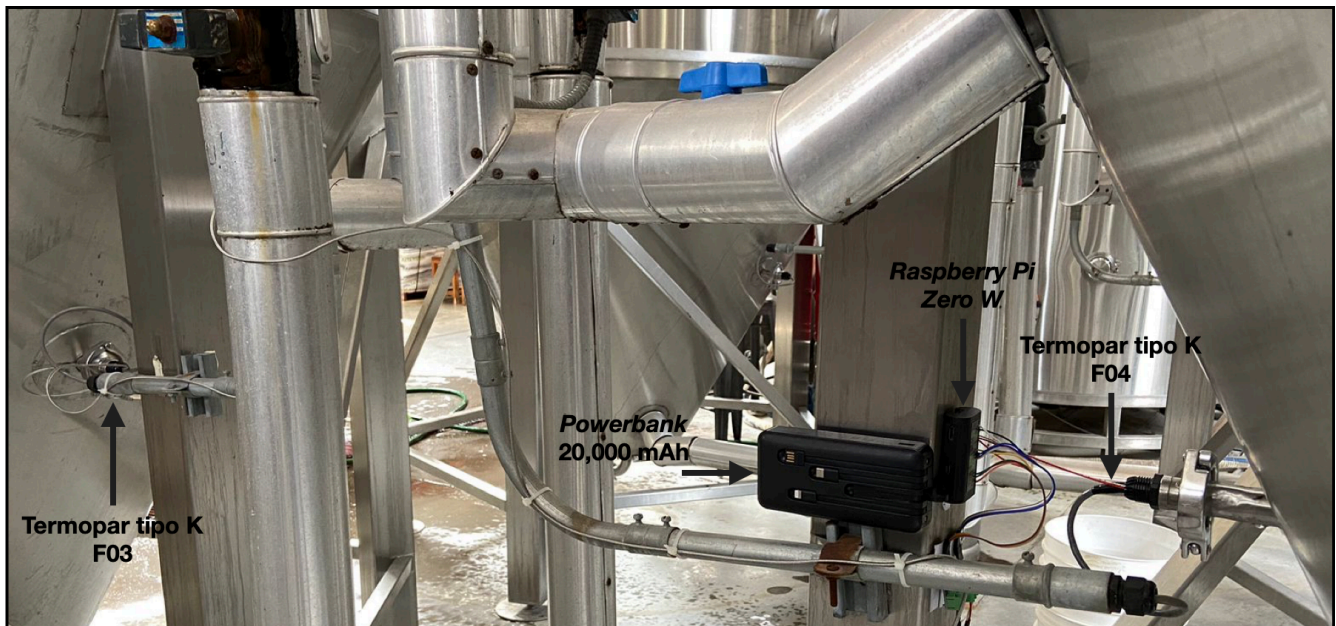
Figura 26. Primer sistema BreweryHub instalado en 28/09/2023 en tanques F03 y F04 de Cerveza Loba.
