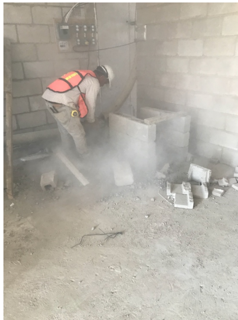
Figura 4.17. Corte de materiales con disco, sin equipo de protección.
