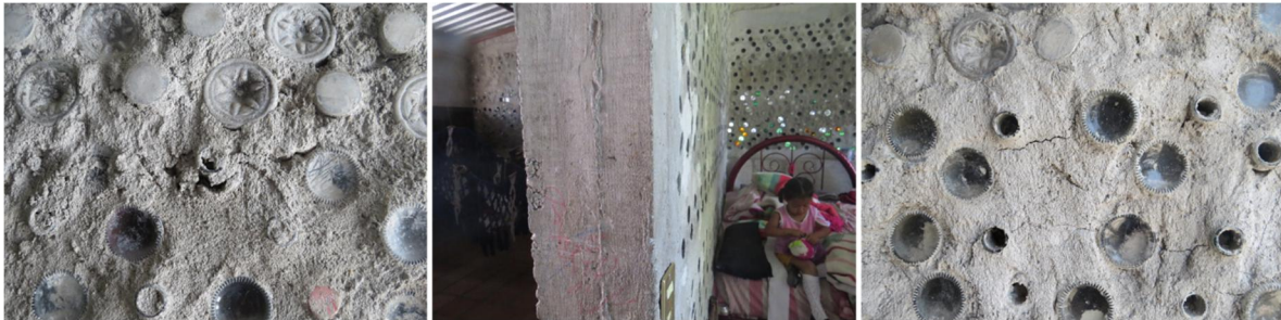
Figura A3. 6. Agrietamientos y fisuras en los muros.
