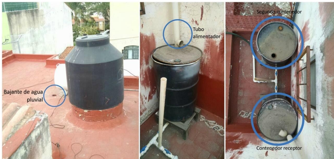
Ilustración 97. Serie de fotografías de ubicación de bajante y contenedores del sistema. Fuente: Elaboración propia.
