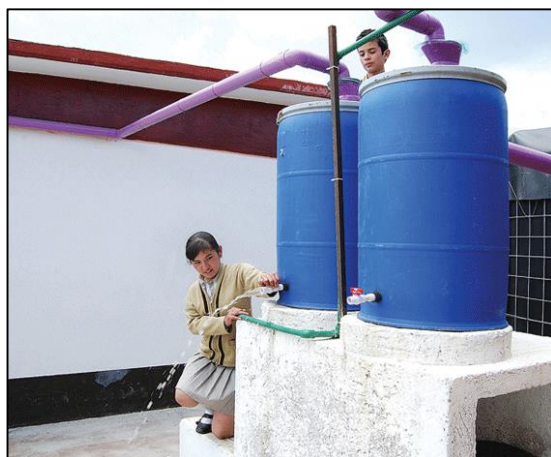
Figura 16. Captación pluvial, escuela No. 120 Fuente: Delegación Tlalpan, 2016
