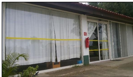
Figura 85. Medidas de seguridad en ventanas Fuente: Acervo del autor
