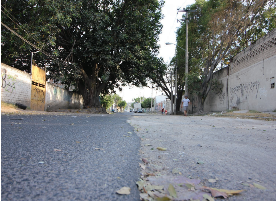
Deterioro y división municipal en calle Ahuehuetes
