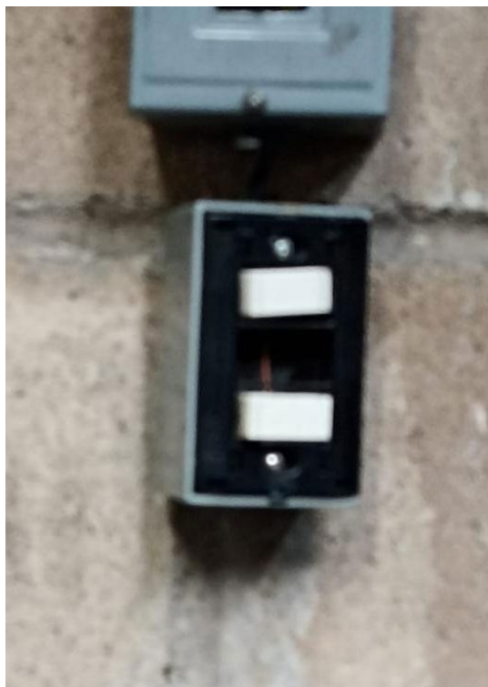
Imagen 65. Evidencia de riesgo “potencial” detrás de la maquina 2 en el área operativa. Tomada por equipo PAP CC P.2026
