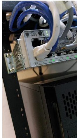
Figura 3 “Cables de red caseta Tepatitlán”
