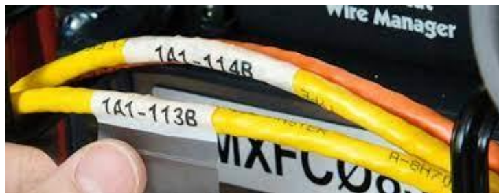
Figura 7 “Identificación de cables de red”
