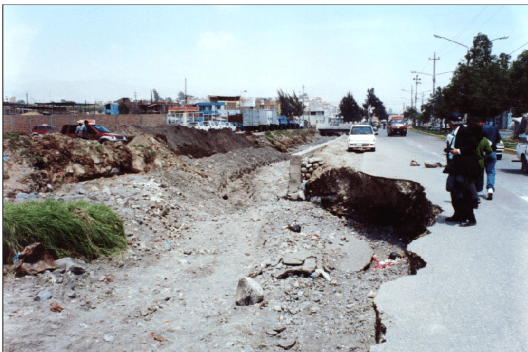
Figura 49. Erosión de pista urbana Arequipa (Kuroiwa, 2002).
