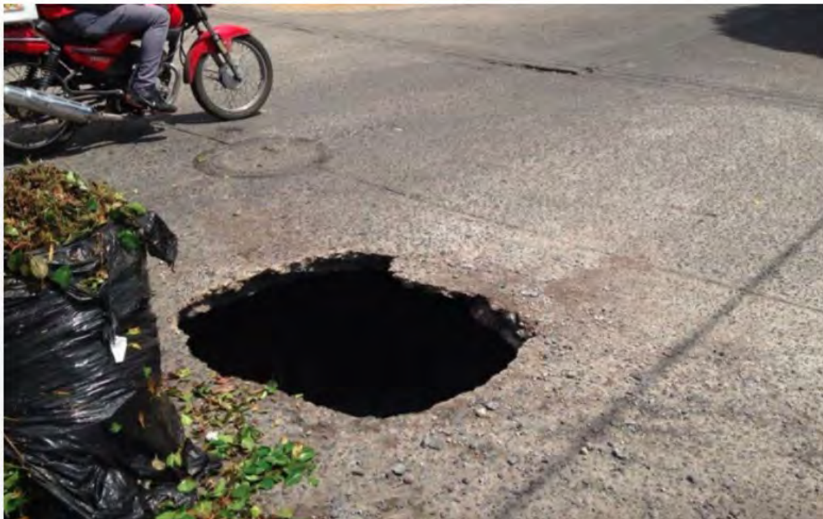
Figura 1. Baches en temporadas de lluvia en el AMG (Tráfico ZMG, 2016).
