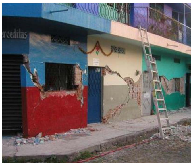
Figura 2.3 Daño generado en viviendas por el sismo de 2004 en Tecomán, Colima (SMIS and EERI, 2006).
