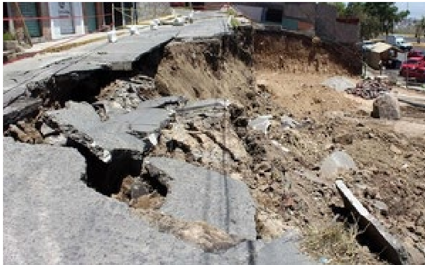
Figura 44. Derrumbes por descenso de los niveles freáticos (Milenio, 2017).
