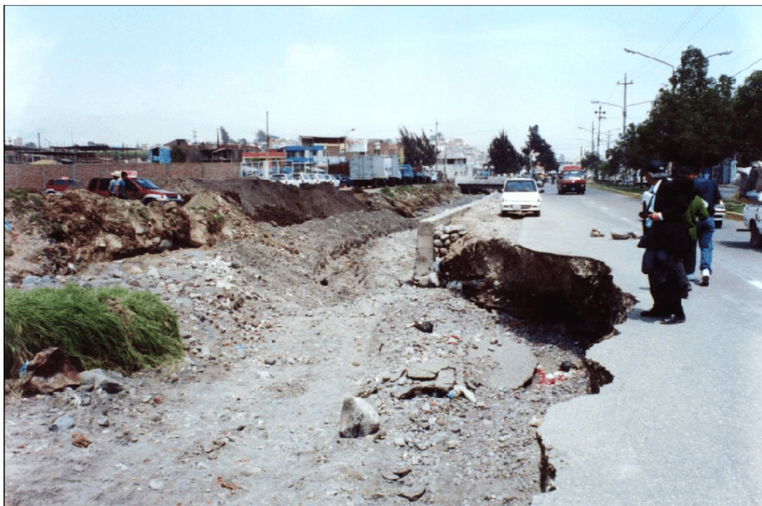
Figura 49. Erosión de pista urbana Arequipa (Kuroiwa, 2002).
