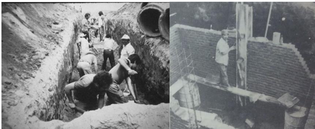
Ilustración 24. Brigadas de trabajo para la instalación sanitaria en la cooperativa Colli Sitio y construcción de viviendas de la unión de solicitantes de vivienda Flores Magón en Colorines. Fuentes: HMMB - Cervantes, 2010 y TAP, 1986.
