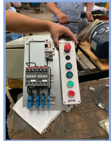
Imagen: Proceso control electrico
